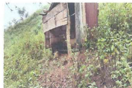
Foto 8: Servicios sanitarios y sus accesorios
