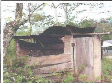
Foto 5: Servicio sanitario y sus accesorios
